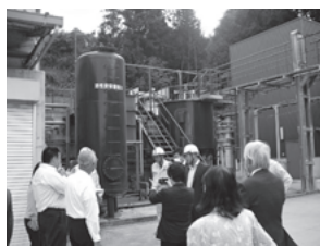
▲処理場内の水処理施設 【(株)ヤマゼン 上野エコセンター】
