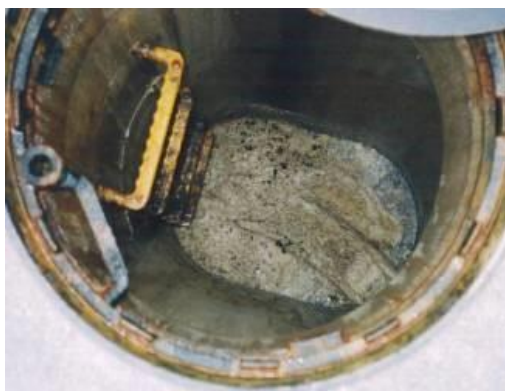
油分が固着した状態
