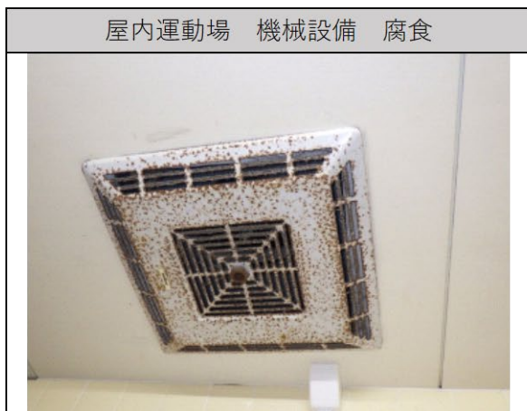
図3-14. 斑鳩南中学校の主な劣化状況
